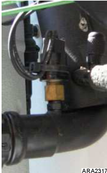
已安装低压切断开关
