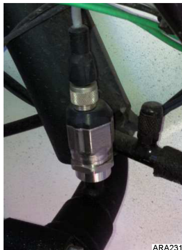
Установлен датчик давления всасывания
