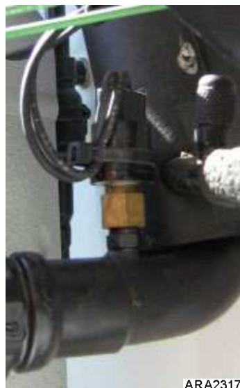
Установлено реле отключения по низкому давлению
